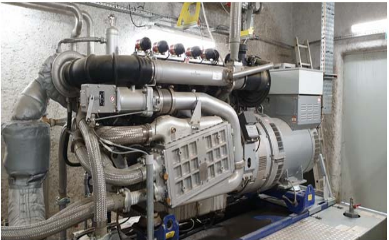
PHOTO 4 : moteur de 220 KW (GAEC DES PINS)
