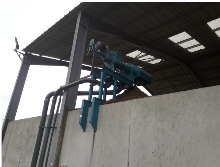
PHOTO 1 : séparateur de phase du GAEC DES PINS
